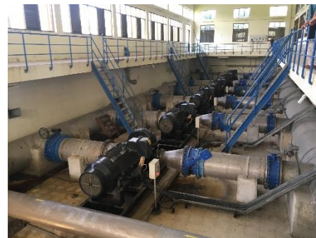
Cau DO 浄水場の既存ポンプ
